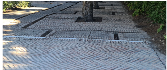
Bloques del suelo deformados por las raíces en patio de entrada
