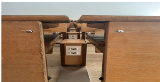
Electrificación entre muebles fijos antiguos (A19)
