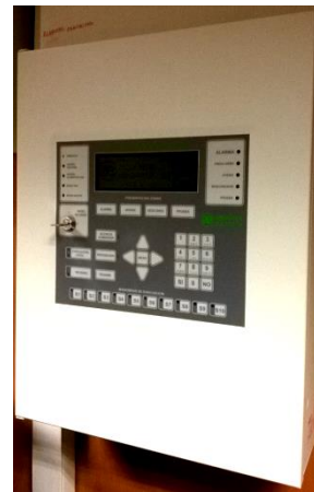
Central de alarma
